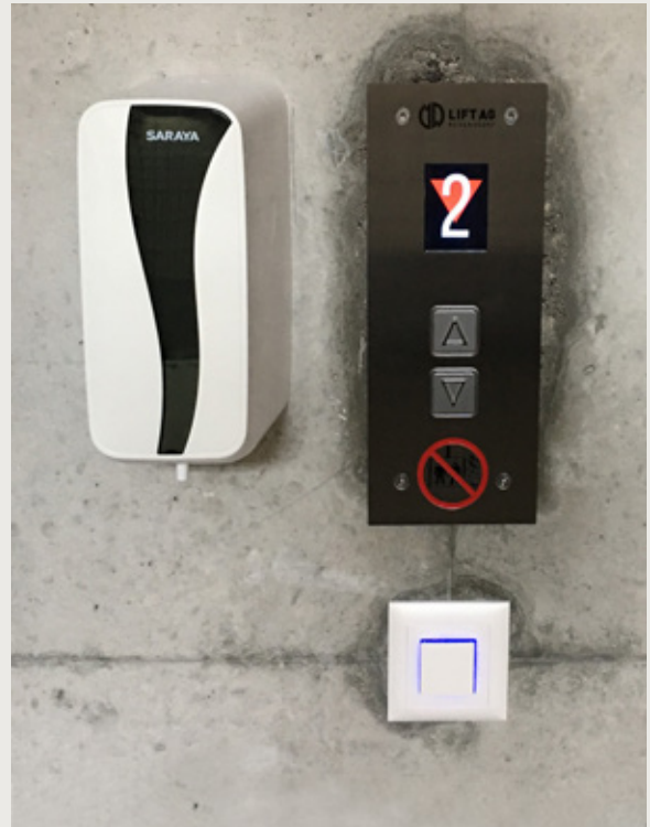
Lifttaste und darunter Lichtschalter in einem Bürogebäude – begleitet vom derzeit üblichen Desinfektionsmittelspender zwecks hygienischer Betätigung der Druckknöpfe.
