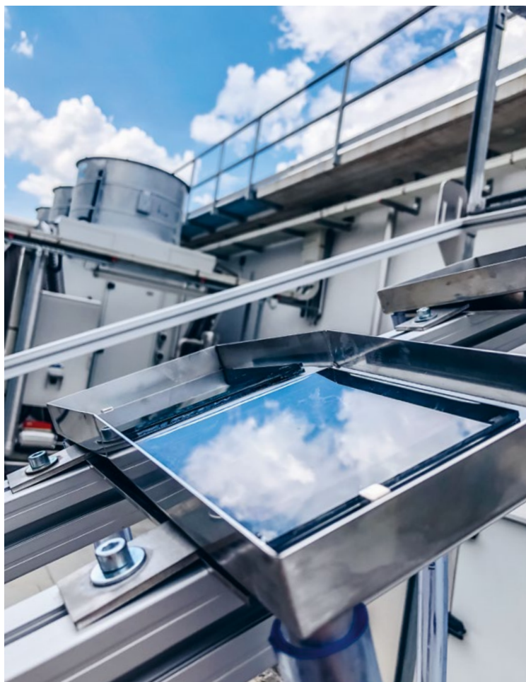
Sur le toit à Muttenz, on teste si du plomb issu des cellules photovoltaïques en pérovskite peut finir dans les eaux pluviales. Photo: mäd
